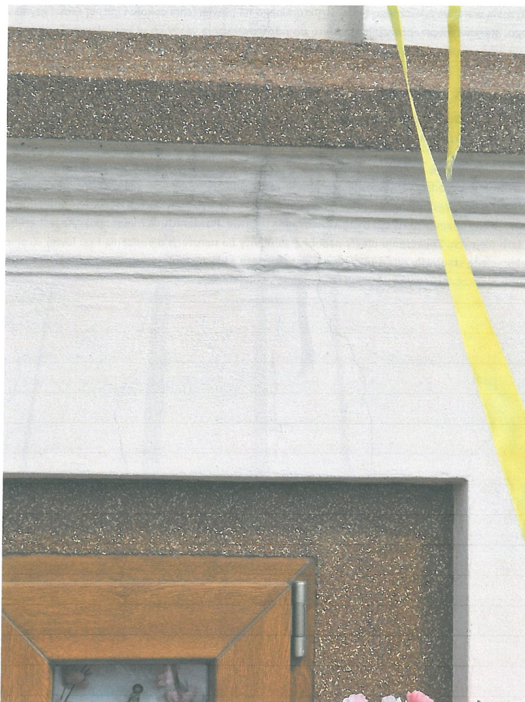
Fot.7 Fragment górnej części trzonu, widoczne spękania gzymsu.
