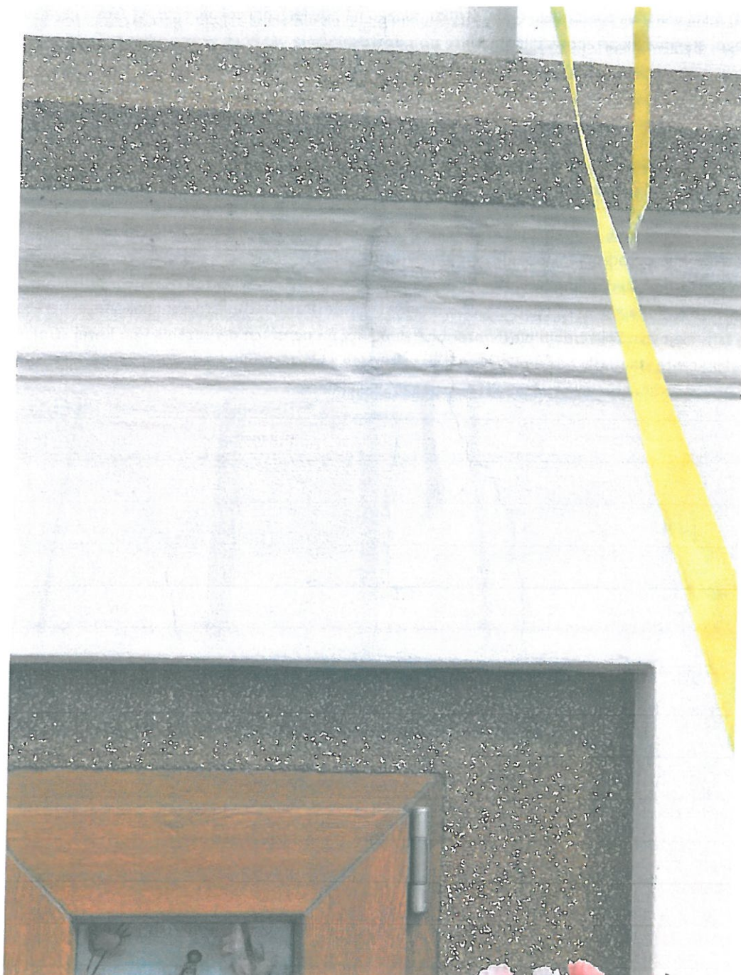
Fot.7 Fragment górnej części trzonu, widoczne spękania gzymsu.
